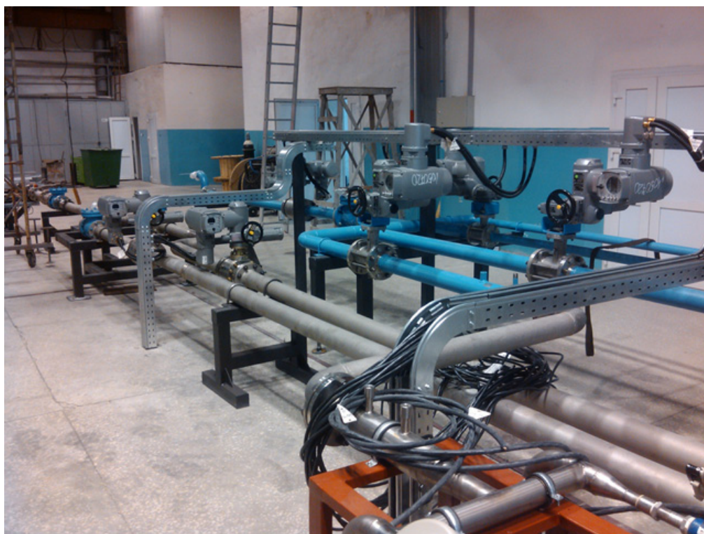
Рис. 4. Фрагмент стенда с установленными устройствами управления. Автоматизация по схеме TPCAC121-1C4-A000
