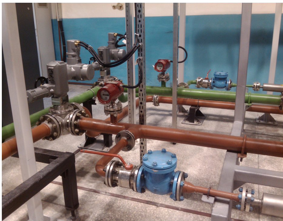
Рис. 2. Фрагмент стенда с установленными датчиками
